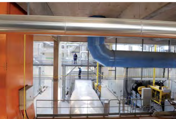
Vue intérieure de la centrale « Noël Pons »
